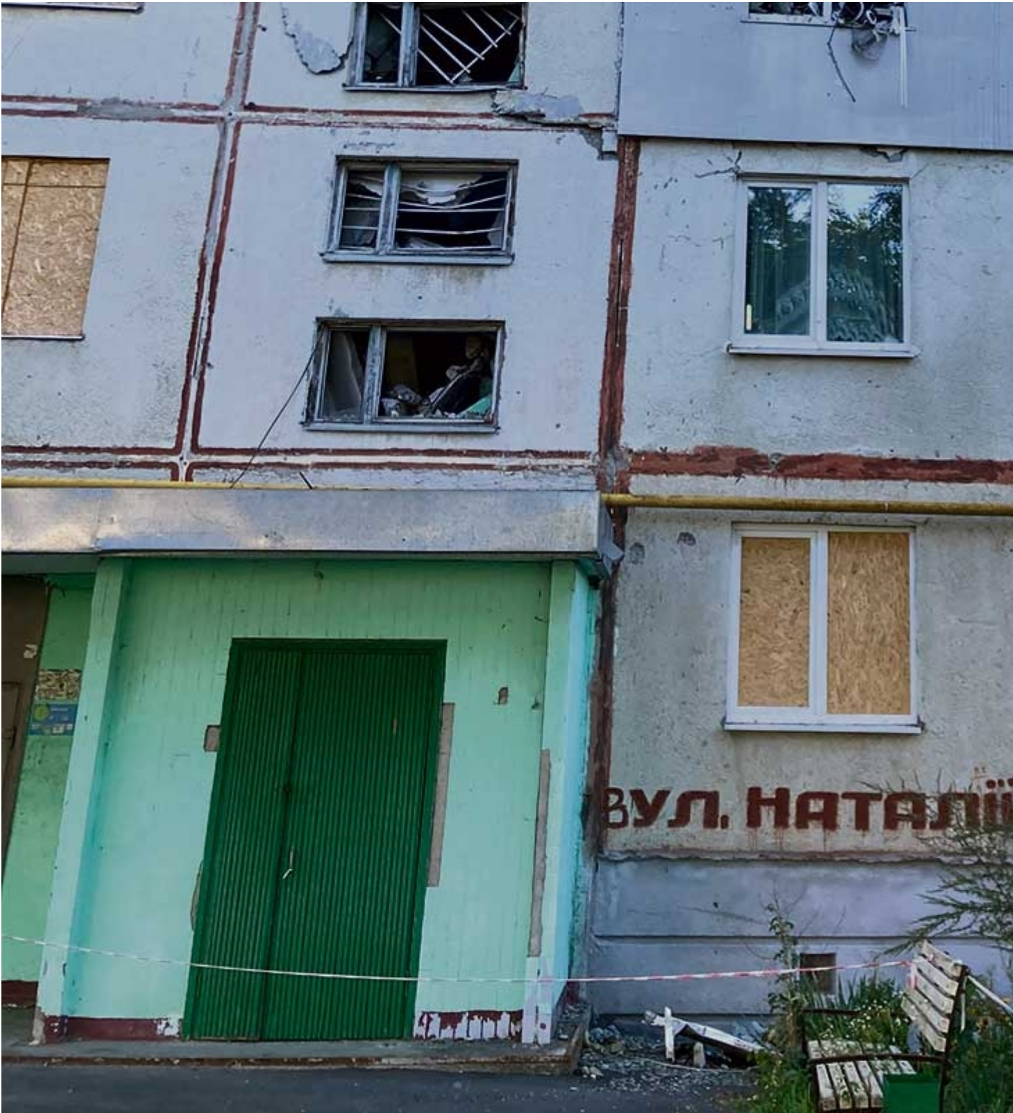
Spuren des Raketenbeschusses. Beschädigtes Haus im Stadtteil Saltywka
